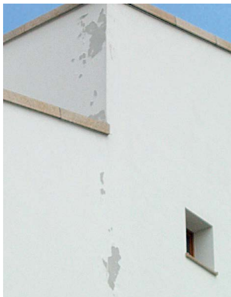
Attēls 6.1. Noslédzošā fasādes apdares apmetuma atslāņošanās
