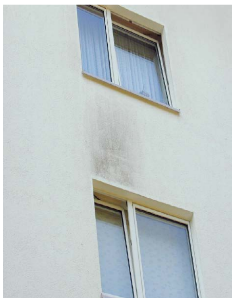
Attēls 2.1. Nolietojusies, netīra fasāde
