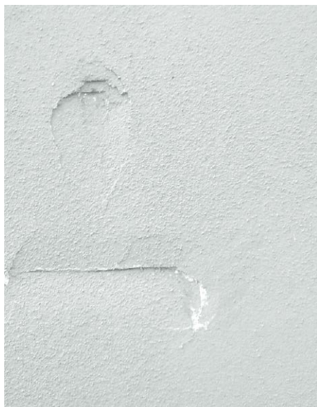
Attēls 8.1. Visas siltināšanas sistēmas t.sk. siltumizolācijas bojājumi
