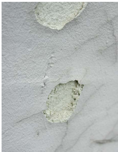
Attēls 9.1. Visas siltināšanas sistēmas t.sk. siltumizolācijas bojājumi
